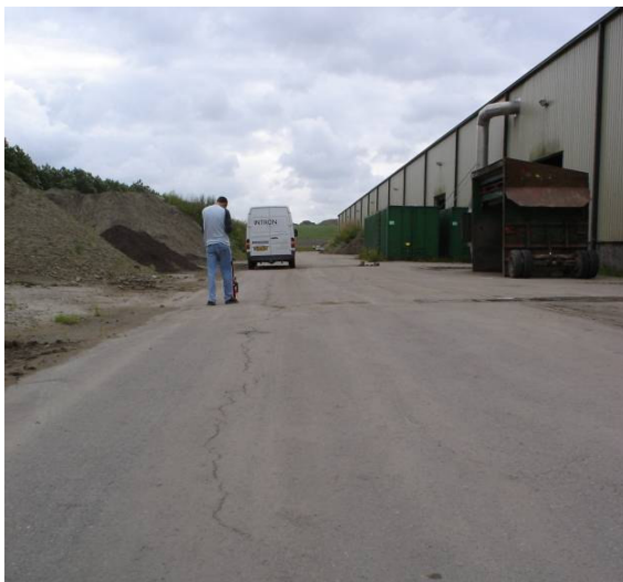
Scheur in de lengterichting van de weg
